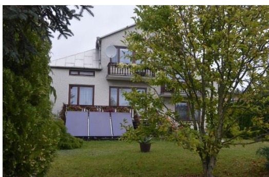
Instalacje solarne na budynku mieszkalnym.
