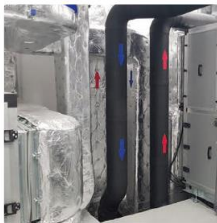
Fotografia 2.36. System rekuperacji hali w Ryczywole Źródło: Sławomir Kalinowski.
